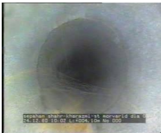
شکل (۲-۳۰) لوله اجرا شده که هنوز از آن بهره برداری نگردیده
